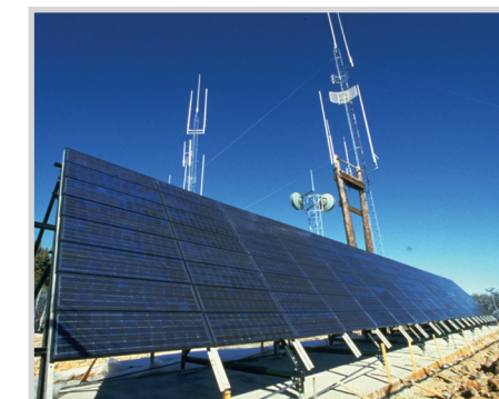
Sončna elektrarna, ki napaja telekomunikacijsko postajo
