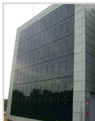
Sončna elektrarna RTP Litostroj
