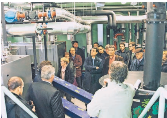
Ogled delovanja biomasne kotlovnice v Osnovni šoli Cerkno
