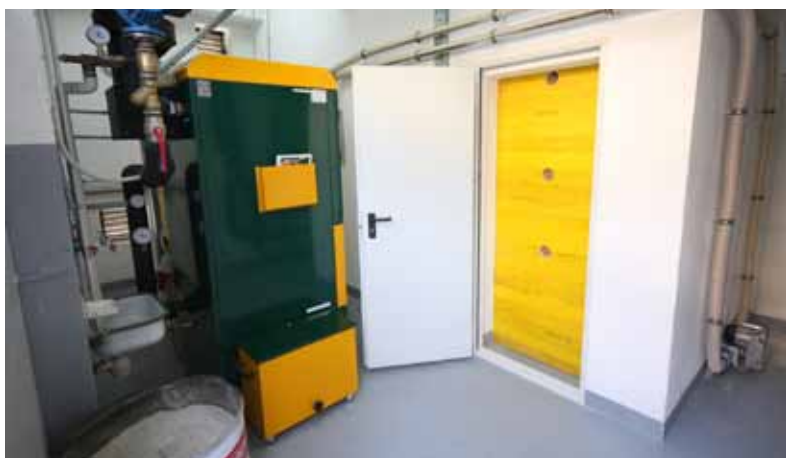
Kotlovnica v Knjižnici Tolmin • foto GOLEA
