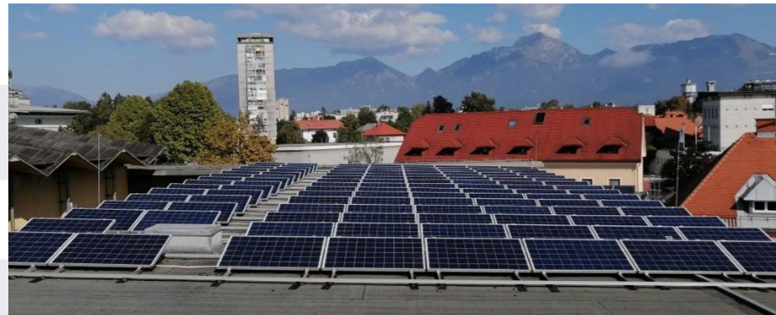
Sončna elektrarna na strehi upravne stavbe MOK
